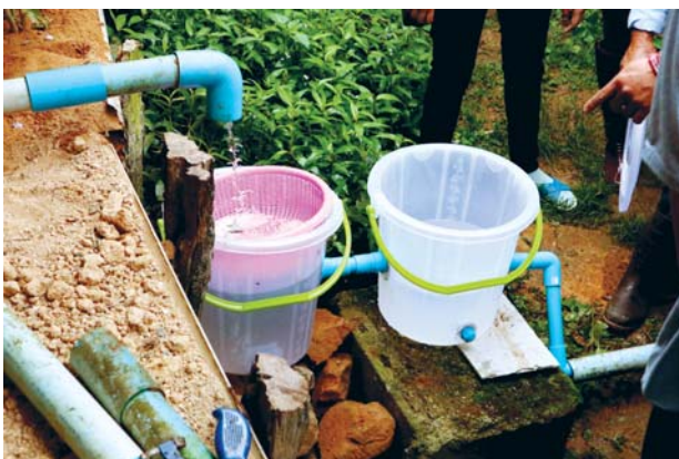
การติดตั้งถังดักไขมันอย่างง่ายเพื่อบำบัดคุณภาพน้ำทิ้ง
